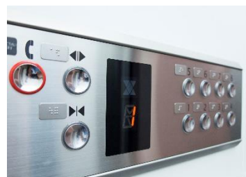
エレベーター操作パネル
